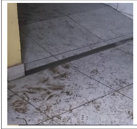
Piso del baño mojado
