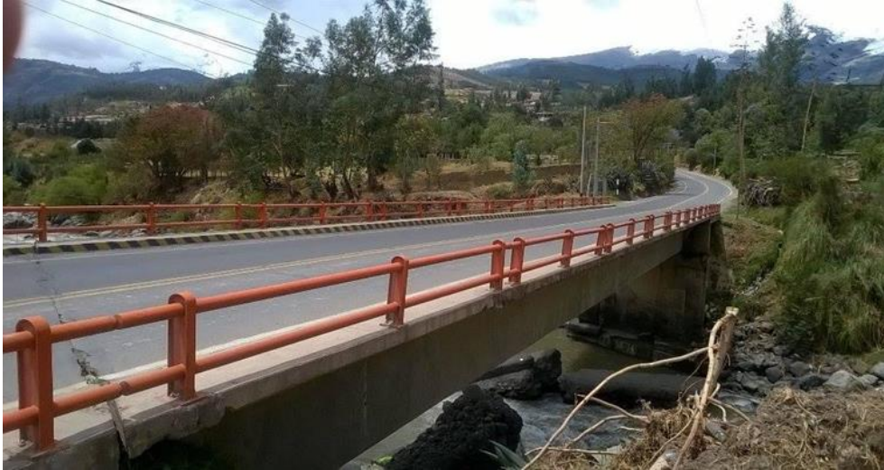
Vista panorámica del Puente Florida y su estribo socavado.
