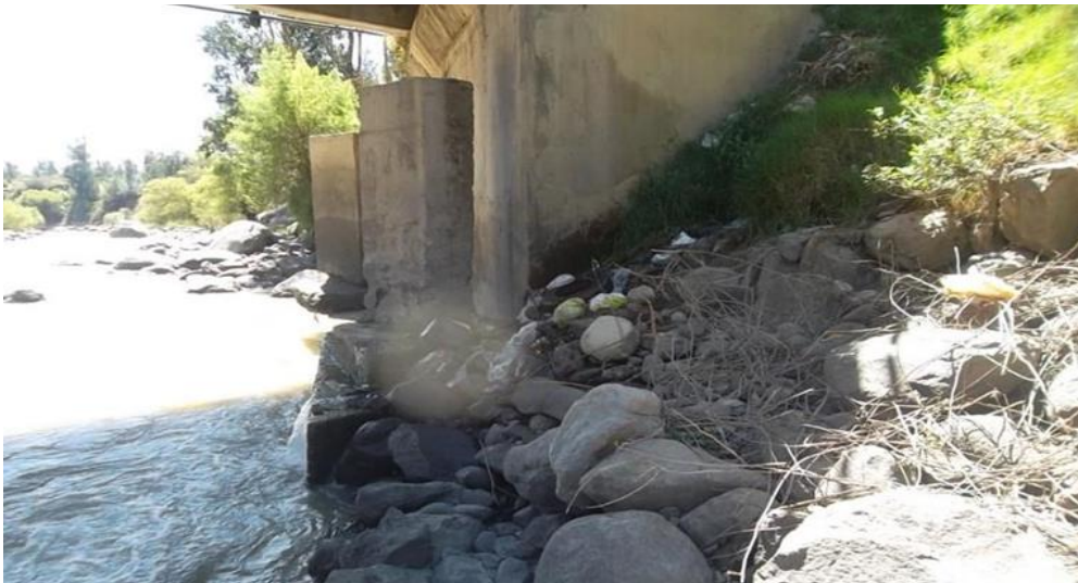
Vista del estribo afectado en el puente Florida
